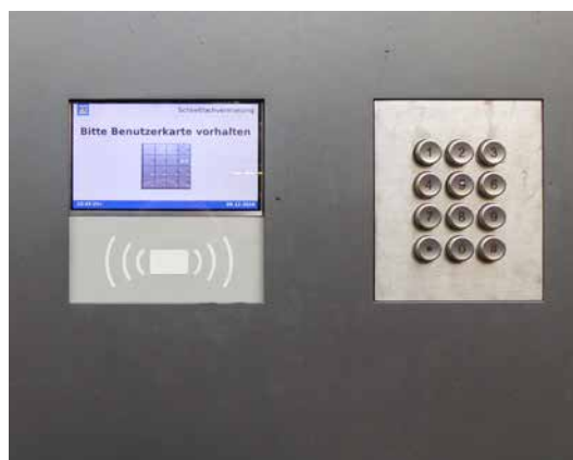
Elektronisches Zugangssystem in Hamburg
