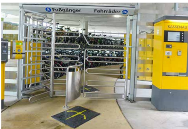
Drehkreuzanlage in Freiburg
